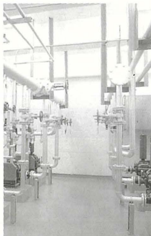
ブロック設備
