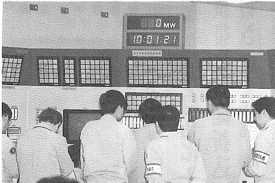
▲「もんじゅ」中央制御室
