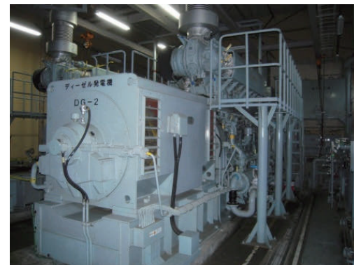
非管理区域にある設備の一例 （解体・撤去する設備）
