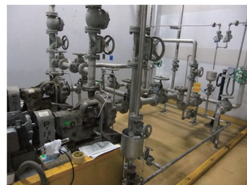
管理区域にある設備の一例 （配管等の汚染調査する設備）
