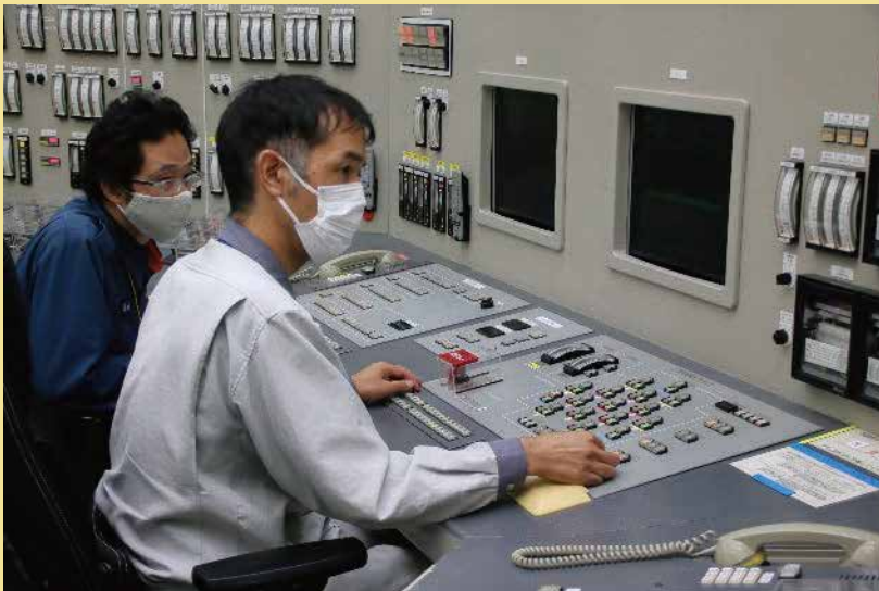
運転再開時の制御室の様子
