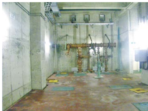
港中央中継ポンプ場
