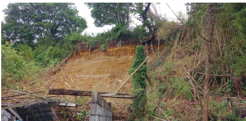
令和5年の大雨により崩壊した箇所
